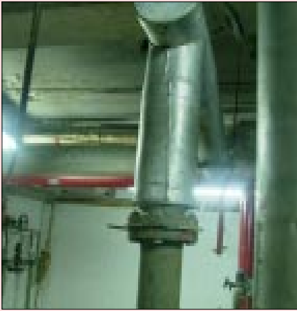
Red de calefacción para el 5° Piso
