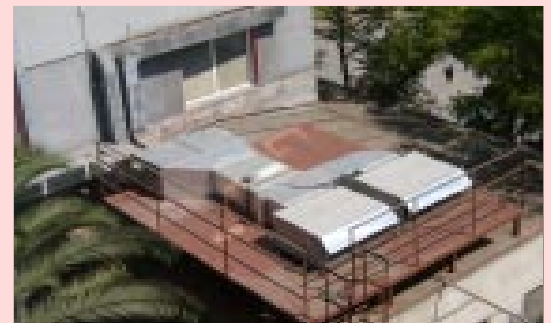
Nueva Unidad de aire estéril en pabellones quirúrgicos
